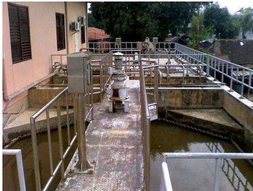
Gambar II.34: Pengolahan Air Limbah di RSUD Ulin Banjarmasin
